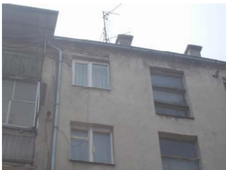
Рис. 2. Відколи цегли зовнішніх стін житлового будинку
