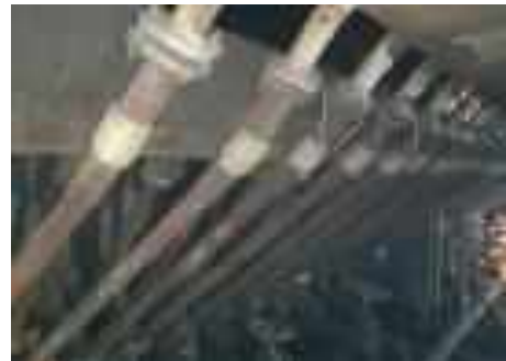
Рис. 7. Колектори вугільного пилу та стисненого повітря, труби для подачі з компенсаторами
